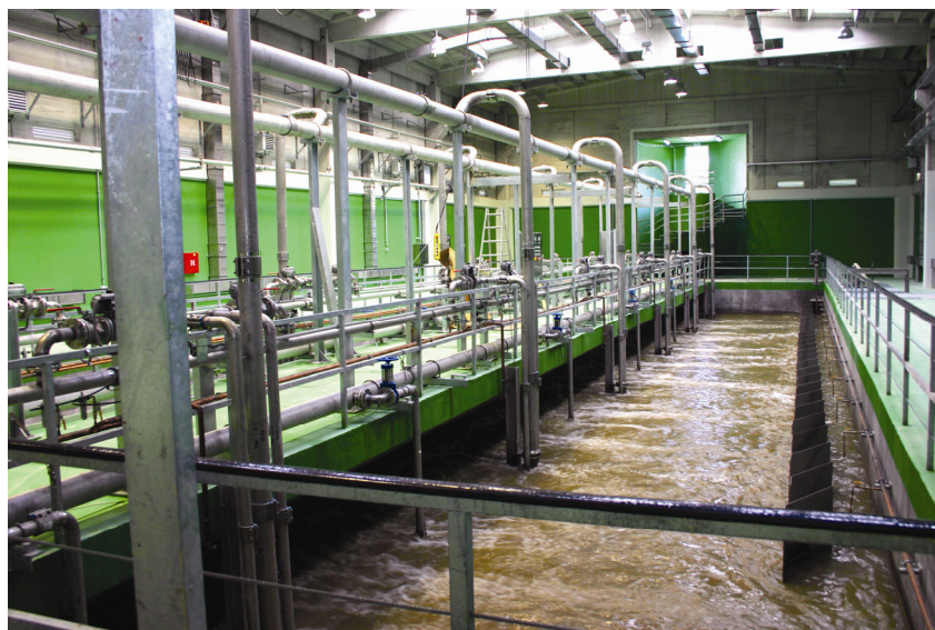
Uređaj za pročišćavanje otpadnih voda Stupe u Splitu
